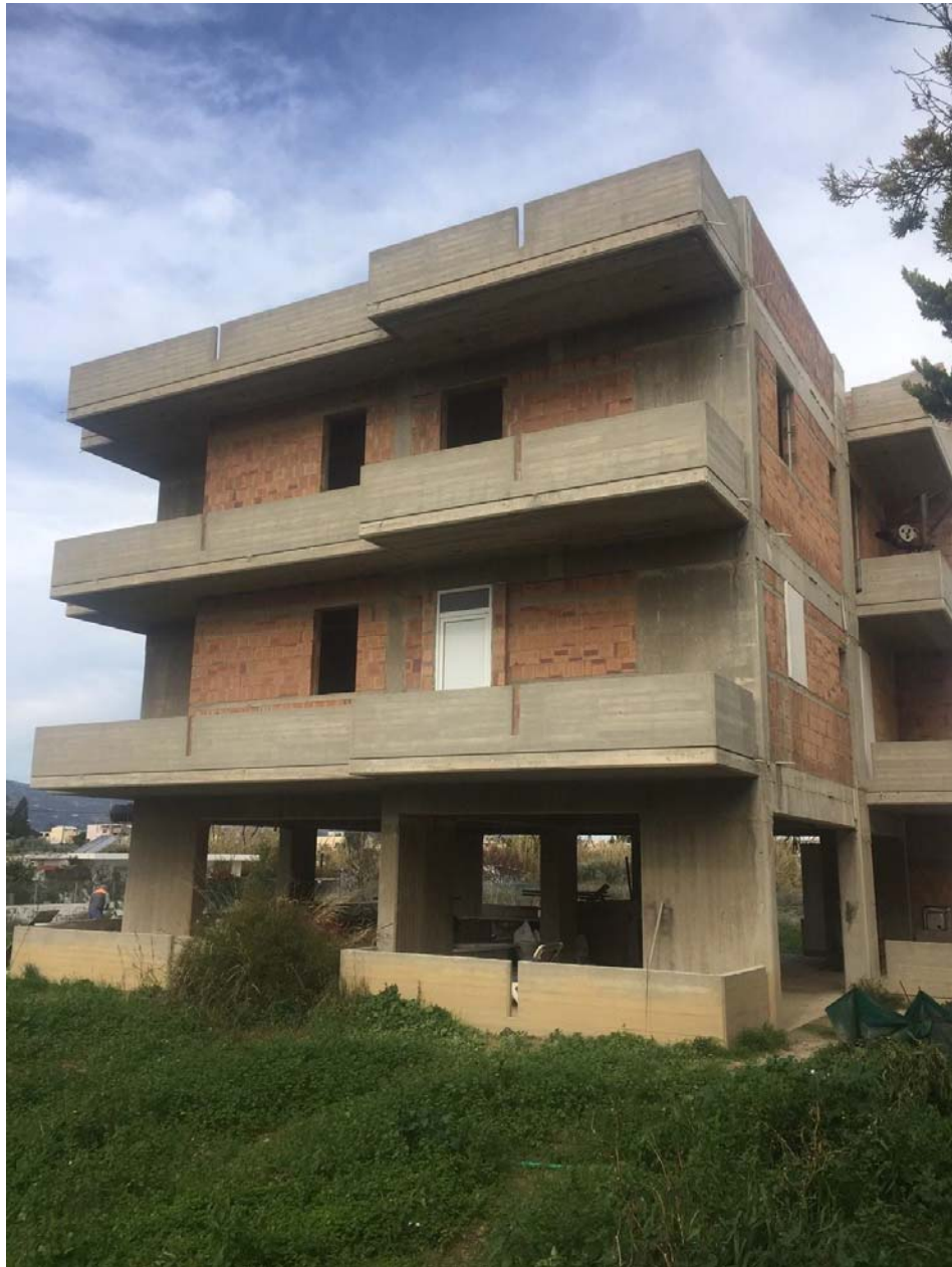
Το παράδειγμα του αυθαίρετου τριώροφου κτιρίου στο Ηράκλειο, κατασκευής του 2004
