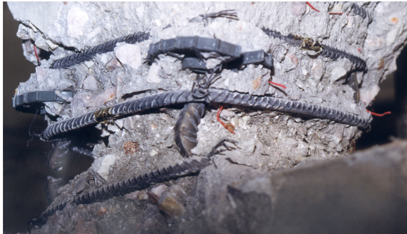
Χαρακτηριστική αστοχία κεφαλής υποστυλώματος.
