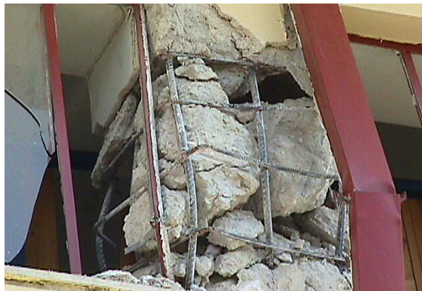
Αστοχία υποστυλώματος κατασκευασμένου με παλιούς κανονισμούς που επέβαλαν ένα περιμετρικό συνδετήρα, που στη συγκεκριμένη περίπτωση ήταν κλειστός σε 90 μοίρες αντί 135 (45) μοίρες.
